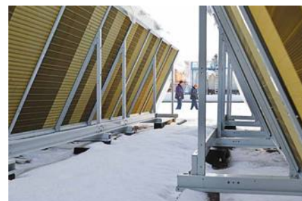
Конденсаторы на промплощадке
