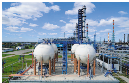
Установка изомеризации «Изомалк-2»
